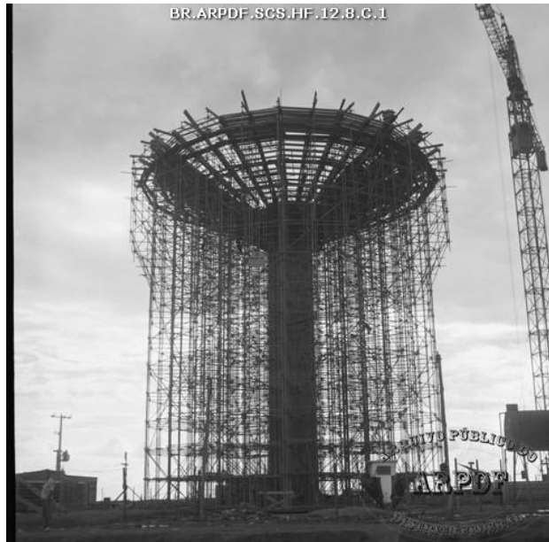
Figura 17 - Obra da caixa D' água Ceilândia DF 06 de dezembro de 1972. Foto Autor desconhecido. Fonte: Arquivo Público DF
